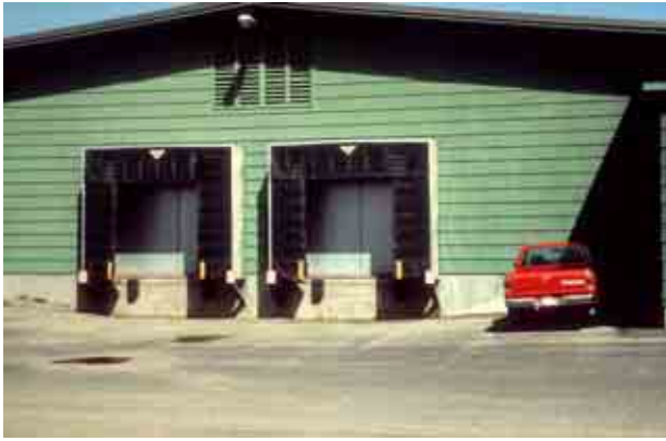
Figura 1.3.37 Las rampas de carga permiten una fácil descarga de los suministros e incrementan la velocidad y seguridad de la carga de planta dentro de los vehículos, aún durante condiciones climáticas adversas.
